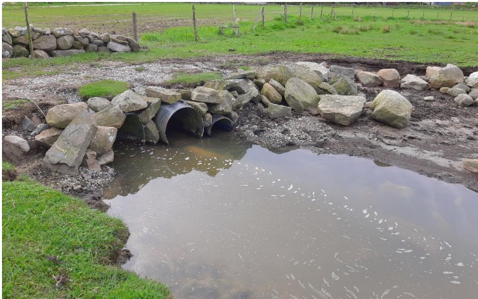
Figur 10. Befintliga dagvattenrör (Foto: Kaisa Carlgren)
